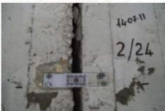
Contrôle de la lésion structurelle
